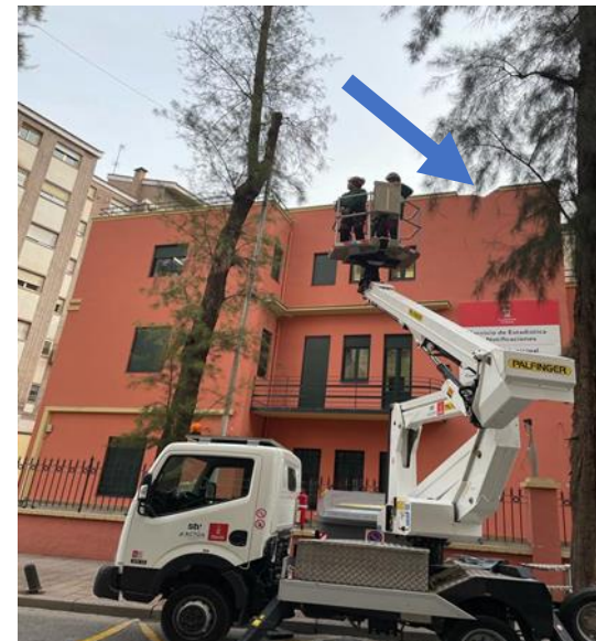
Daños en fachada
